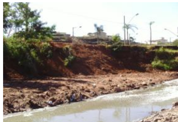
Figura 18: Erosão do talude (enxurrada da avenida e turbilhonamento ao final da canalização).
