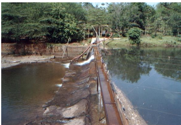
Figura 3.13: Represa da captação em período de estiagem
